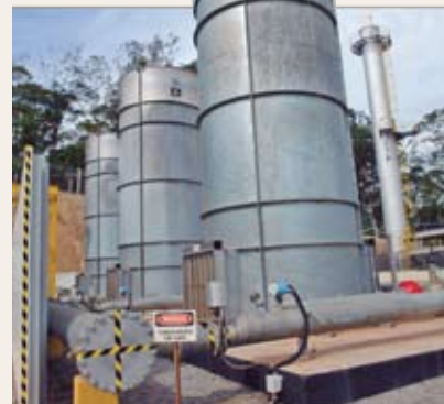
Os queimadores (flares) processam 5.000m³ de biogás por hora
