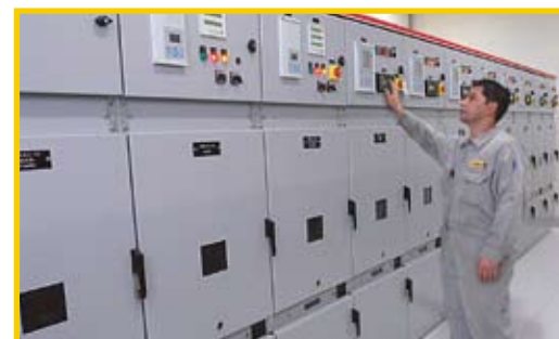
Painéis de média tensão controlam e distribuem a energia gerada pela usina
