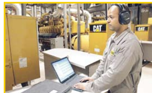
A manutenção dos motogeradores Caterpillar conta com o suporte de testes preditivos no local e monitoramento remoto através da central localizada na Sotreq-São Paulo
